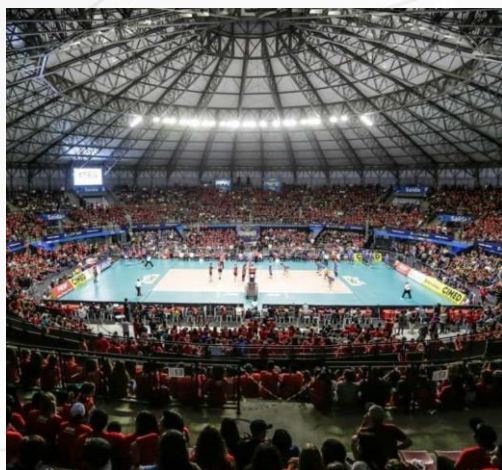
ILUMINAÇÃO LED EM ARENA
