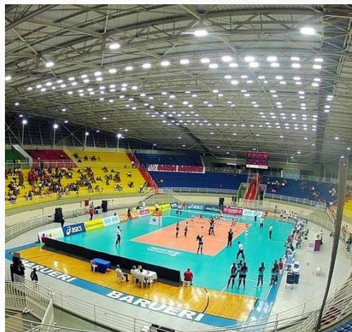
ILUMINAÇÃO LED EM ARENA
