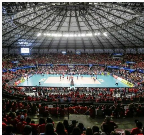
ILUMINAÇÃO LED EM ARENA
