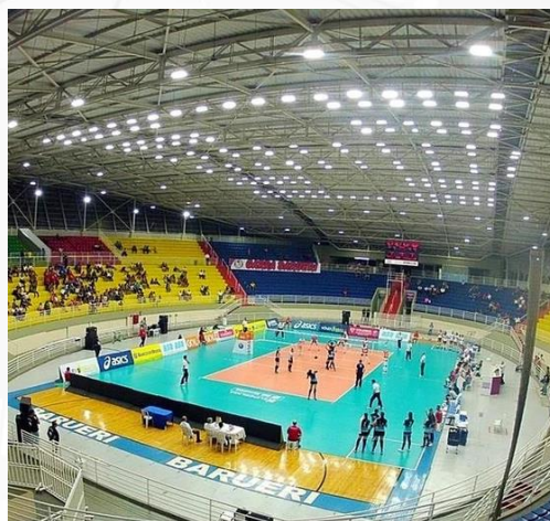
ILUMINAÇÃO LED EM ARENA
