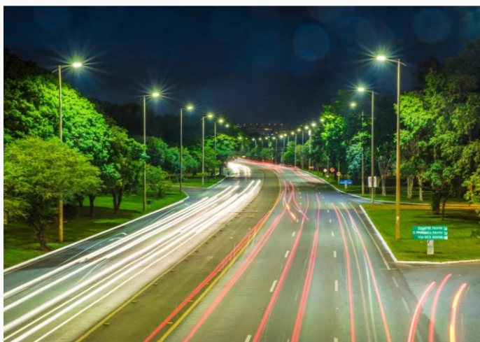
ILUMINAÇÃO LED EIXO RODOVIÁRIO
