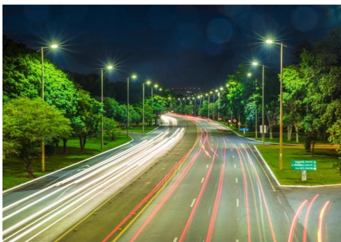
ILUMINAÇÃO LED EIXO RODOVIÁRIO
